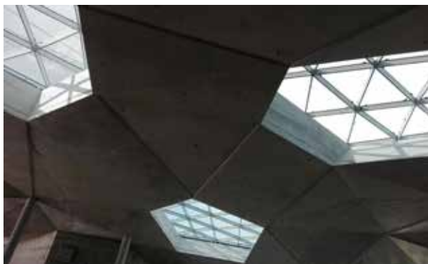
Oberlichter der Osloer Bibliothek wurden in BIM-Arbeitsweise erstellt.
